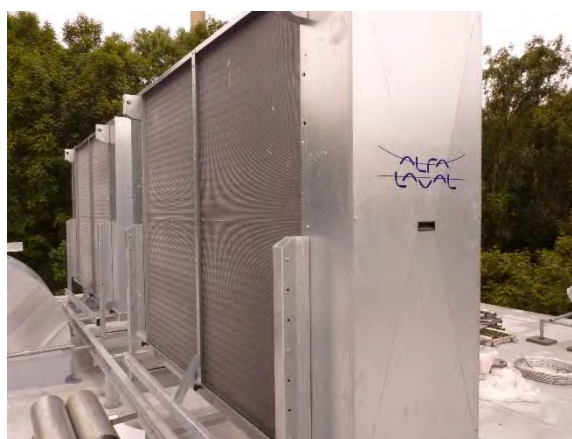
Chladicí věže na střeše nové budovy.
